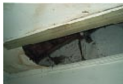
Aspecto do tecto dos WC. Escola do 1º CEB de Sarrazola nº2 -
